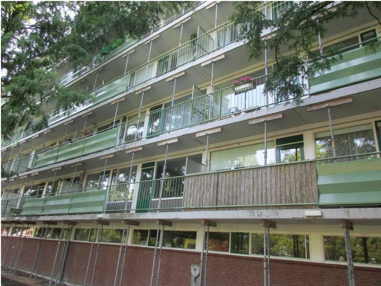
Flats in de Rembrandtlaan zijn ondersteund...
